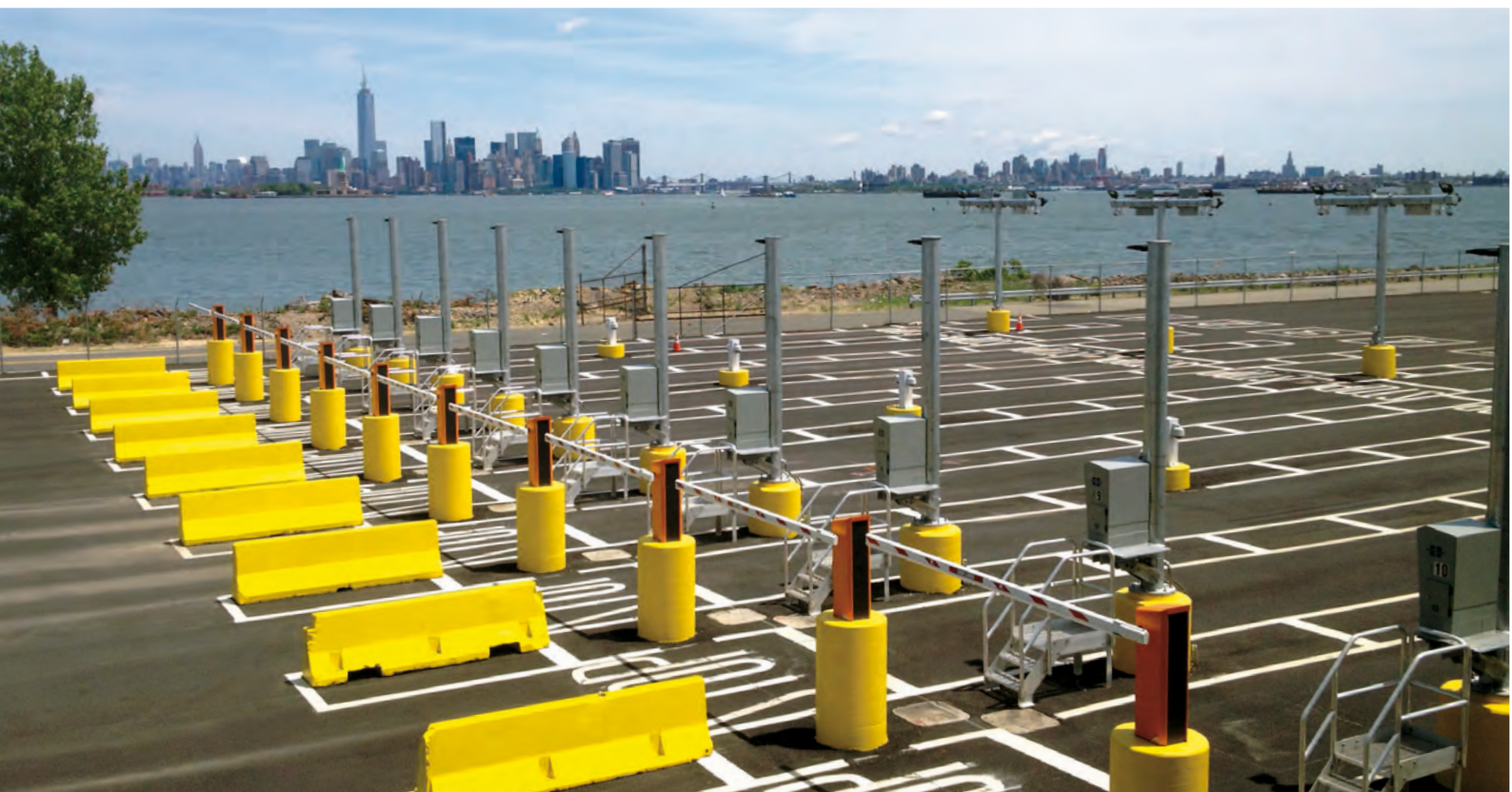
Magnetic.Access Schranken auf Betonsäulen für die Zufahrtskontrolle von LKWs in New York City (USA).
